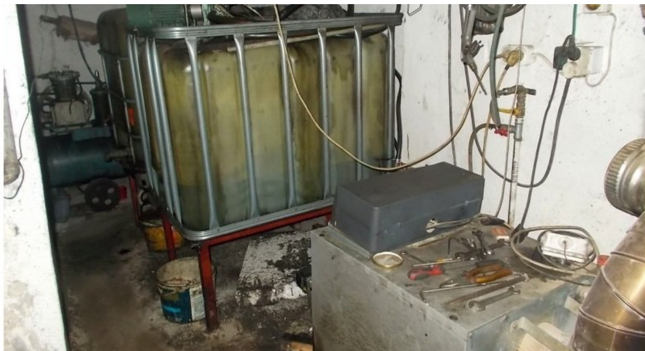
Piece przystosowane do spalania zużytego oleju silnikowego. Fot. Straż Miejska w Warszawie
